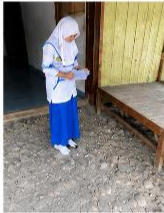
Lantai tidak rata dan bergelombang
