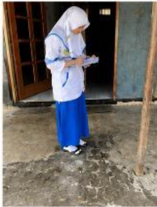
Lantai retak dan berlubang
