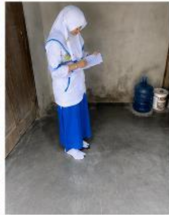
Lantai mudah berdebu dan sulit dibersihkan
