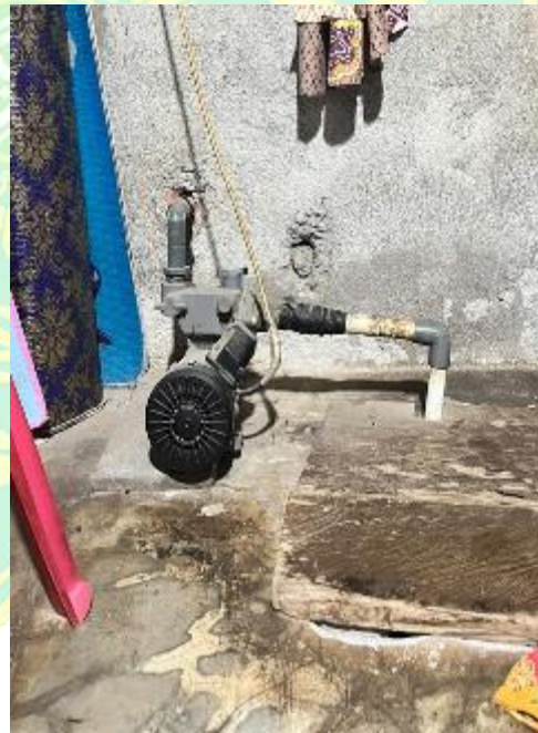
Instalasi pompa sumber air bersih milik responden
