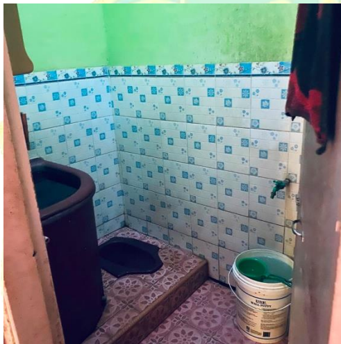
Air Bersih dan Jamban
