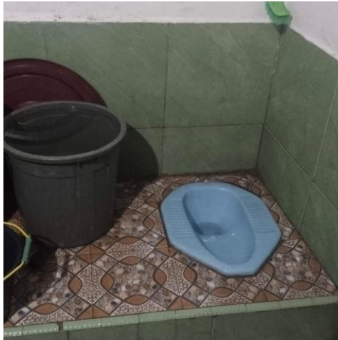
Air Bersih dan Jamban
