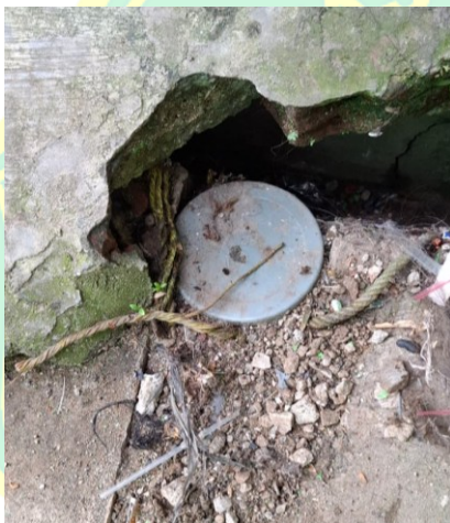
Kondisi di kos B
