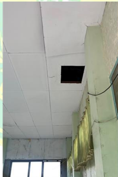
Gambar 1. 3 Penurunan Kualitas Fisik pada Plafon Bangunan Eksisting
